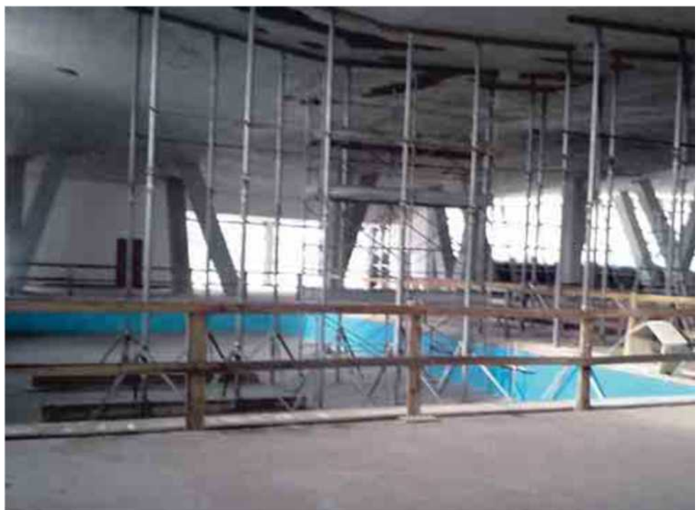
LE CREPE Sopra, l'interno del polo natatorio di Valco San Paolo con i ponteggi e il soffitto pieno di crepe
