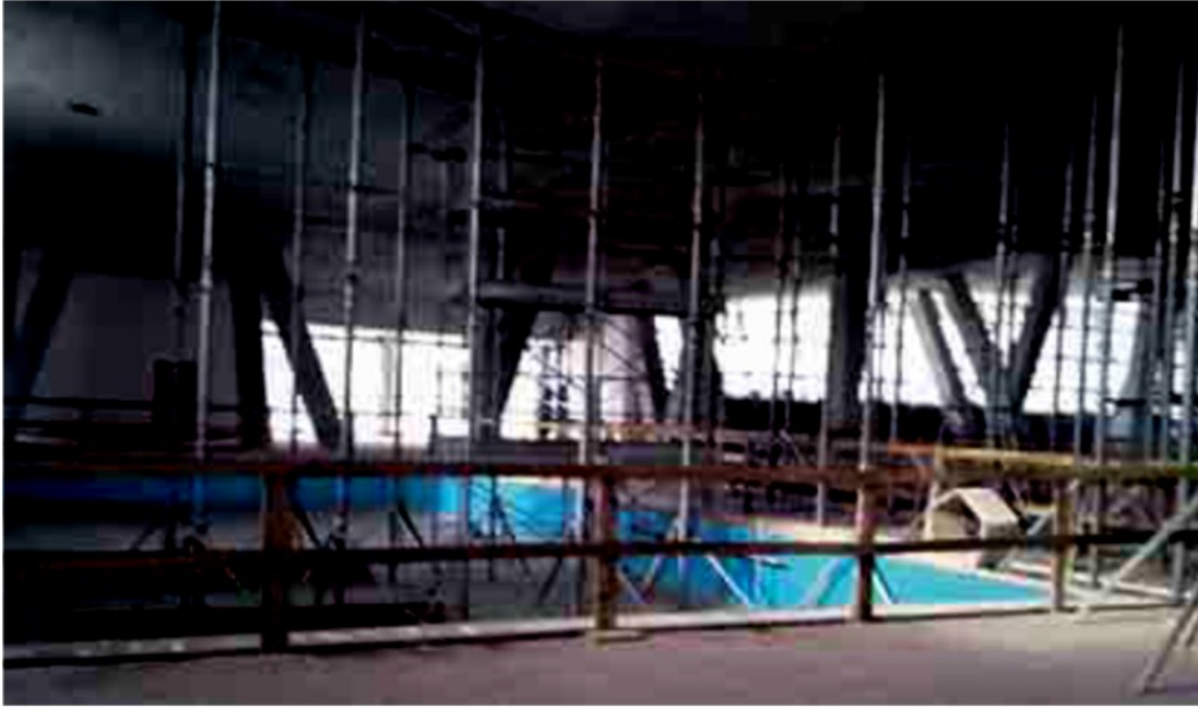
LA PISCINA Siamo entrati nel polo natatorio di viale Marconi: il soffitto è a rischio crollo
