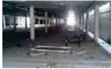
Nel parcheggio sotterraneo al posto delle auto: porte, reti, materassi e mucchi di spazzatura
